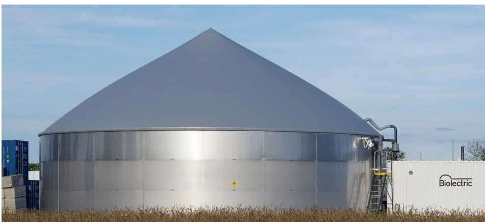
Figuur 5-2: Voorbeeld van een vergister van Bioelectric.
