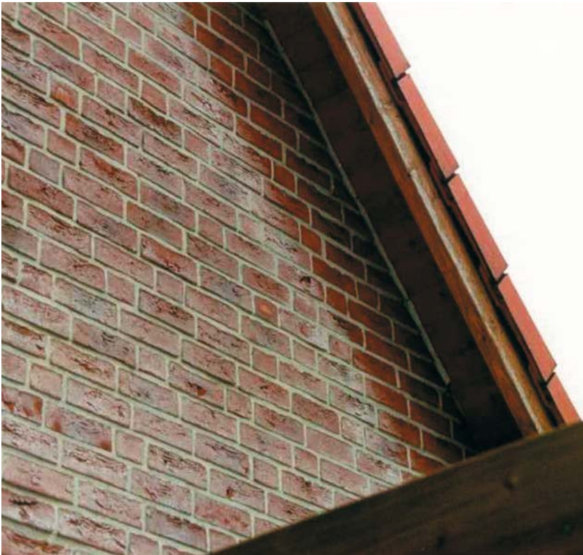
Vergipsing: kenmerkend is de scherpe begrenzing tussen het beregende en droge deel van de gevel.
