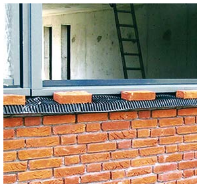
Tijdelijke waterslag tegen inregenen in het metselwerk.
