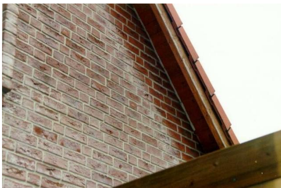
Scherpe begrenzing tussen het beregende en met zon beschenen gedeelte en het droge deel van de gevel.
