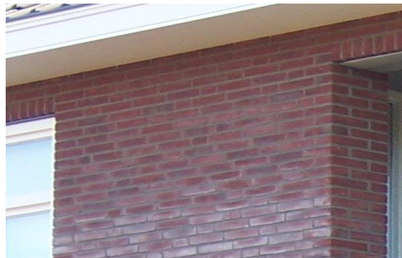
Bestanddelen die vergiftiging veroorzaken verplaatsen via de poriën in de mortel en de steen naar het oppervlak. Water verdampt en gips wordt als uitslag zichtbaar aan het oppervlak.
